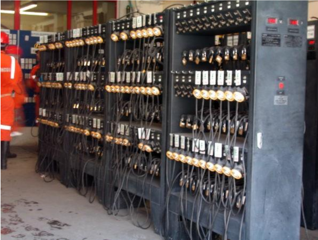
Linternas de los cascos de los mineros cargando baterías en la lampistería de la mina.
