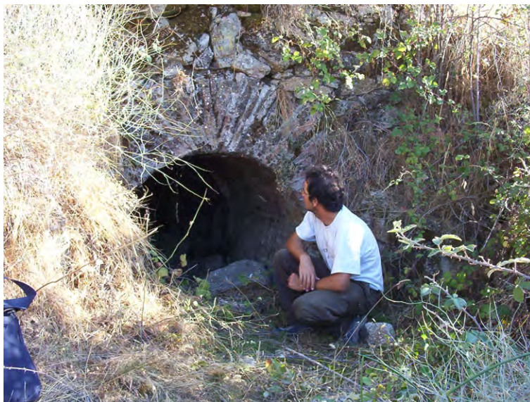
Figura 133: Emboquille de la galería inferior de Peñalvero. Fotografía tomada en 2005. Visitamos de nuevo la mina en 2006. En 2007 se derrumbaron 10 m de galería.
