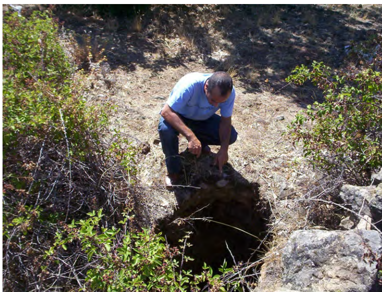
Figura 10: Subsistencia minera en Gargantilla de Lozoya en 2005: colapso de techo de la galería más somera.
