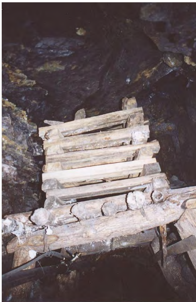
Figura 54: Llave para transmitir cargas en una zona sobre excavada. Típico en zonas de filones, vetas y cuñas de roca.
