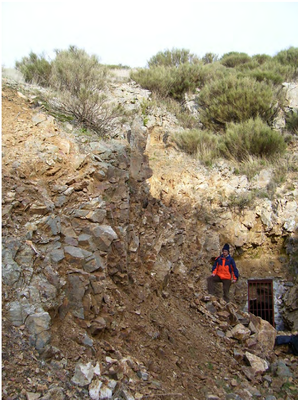
Figura 179: Aspecto que ha presentado el emboquille de la mina de Bustarviejo hasta finales de 2007. Nótese la caída de bloques y la degradación del macizo rocoso por gelifracción. (fotografía tomada en 2006).
